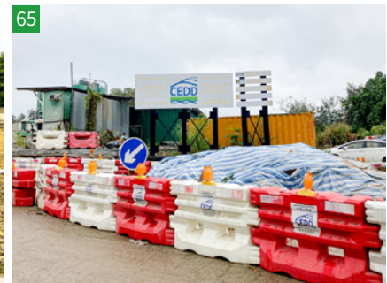
圖 65：DLON114 的工程，屬於「沙嶺墳場興建骨灰安置所、火葬場及有關設施的土地平整及相關基礎設施工程」的一部分
