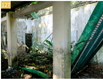
圖 127：內部情況—有部份鐵皮屋頂已塌下
