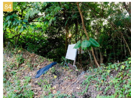
圖 84：用地的邊界一部份圍欄已經塌陷
